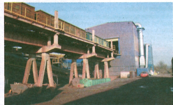
Pohľad na vysokú rampu s technológiou rotačného výklopníka s filtermi v prevádzke.
